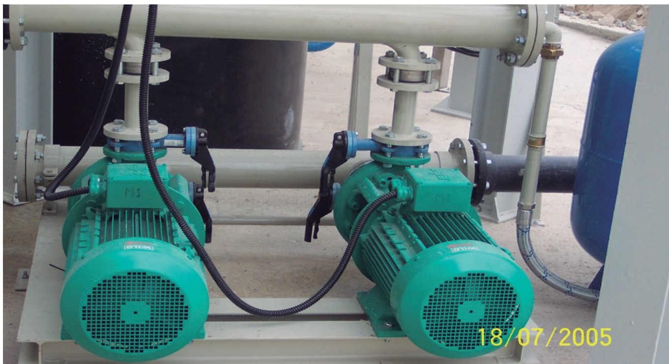
Central de Bombagem para 100 m 3
