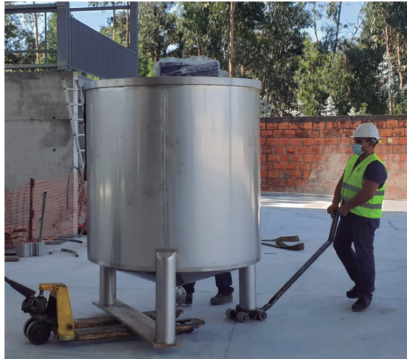
Exemplo: Tanque de homogeneização de lamas
