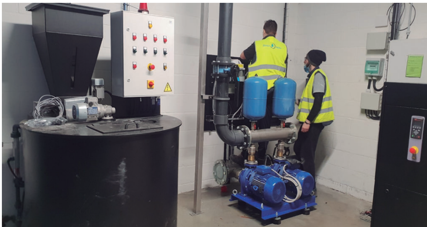
Central de Bombagem de Água limpa para 70.000 litros/hora
